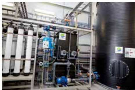
Systeme de purification des eaux pluviales
