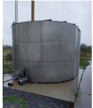
Cuve pour la récolte des eaux usées
